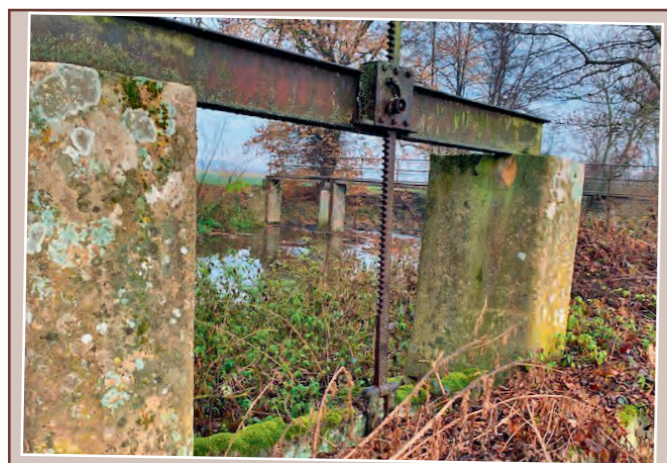
Les 2 barrages de dérivation
